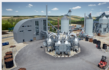
Centrale de cogénération du site de Gyé-sur-Seine avec les fours de pyrolyse et les silos sécheurs de bois en arrière-plan à droite.
